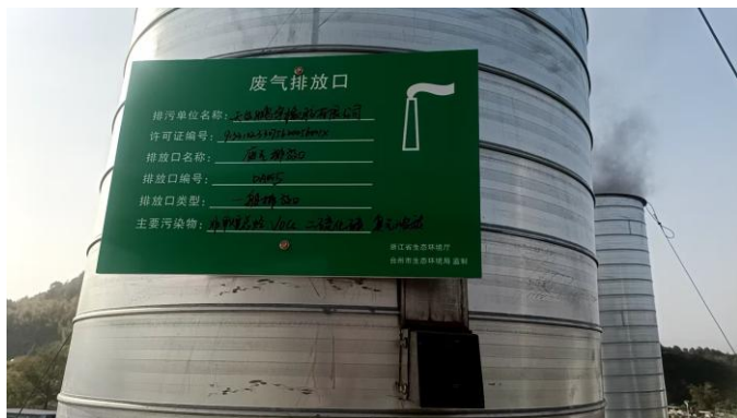
硫化及冷却废气、二次硫化及冷却废气废气治理设施及排气筒
