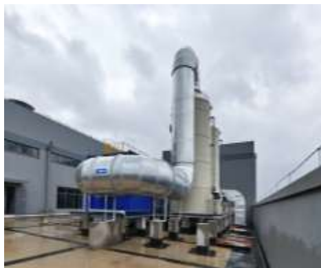
烘胶废气、混炼胶停放废气、胶片冷却废气 废气治理设施
