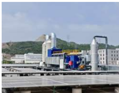
硫化废气 废气治理设施
