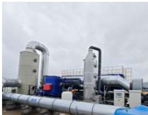
塑炼废气、混炼废气、挤出压片废气 废气治理设施
