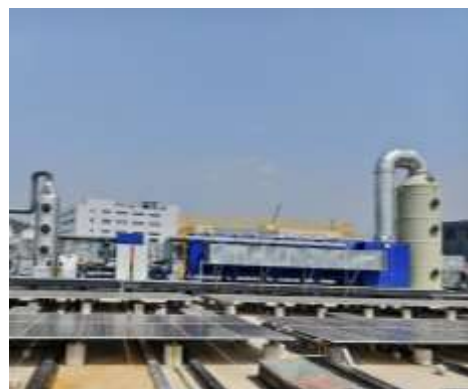
挤出废气、压延废气 废气治理设施
