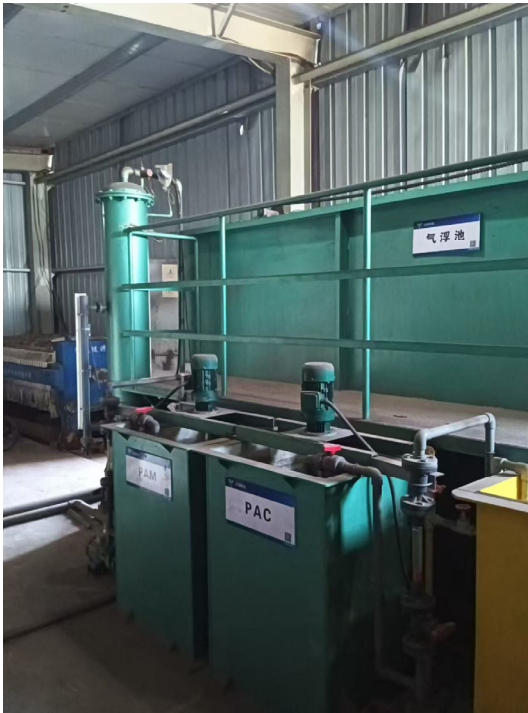
厂区污水处理站
