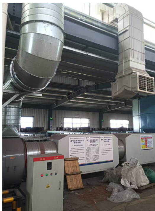
制芯废气布袋除尘+活性炭吸附装置
