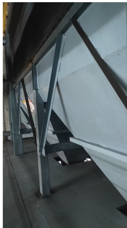
钢丸浇注高温布袋除尘装置
