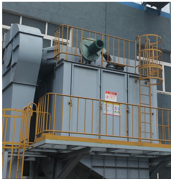
中频炉熔化、浇注高温布袋除尘装置
